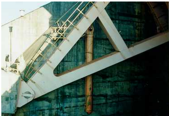
Fig. 1 - Situación de la Compuerta y Servomotor después del accidente
